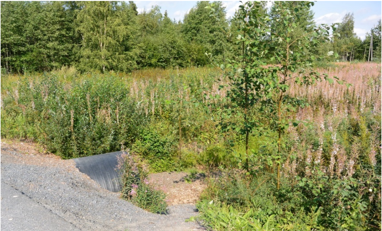
Kuva J. Oja ja Puuttomantien alittava ojarumpu
