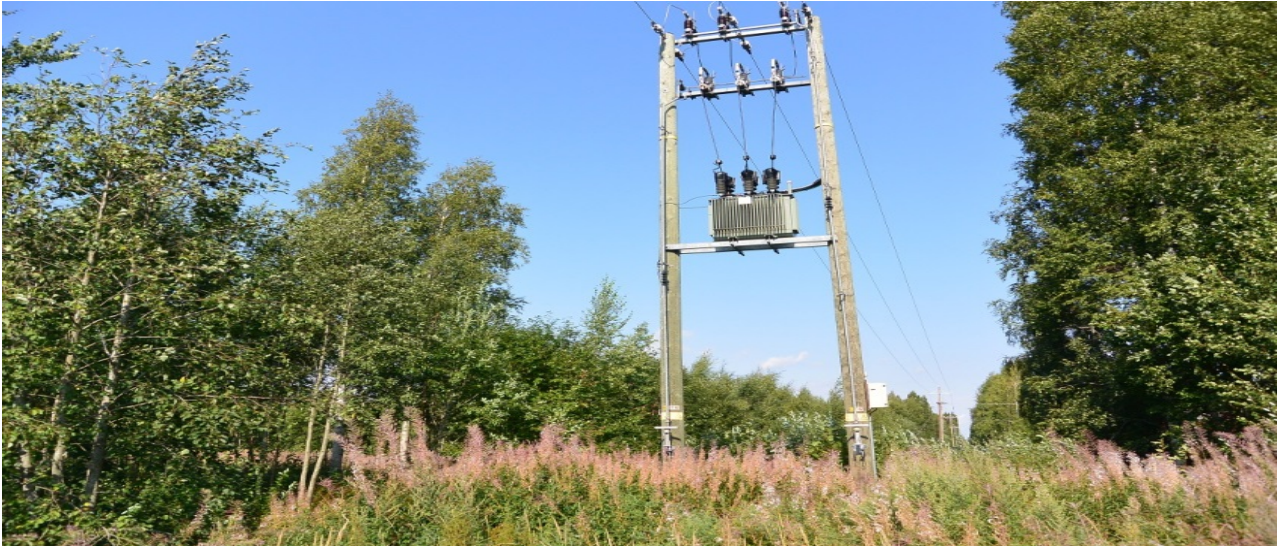
Kuva A Sähkölinja ja muuntaja
